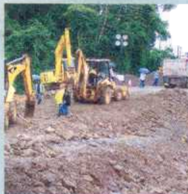
Hasta ayer en la tarde las cuadrillas del MOPT trabajaban para abrir el paso en el kilómetro 82 de Cambronero. DIEGO CASTILLO GN
