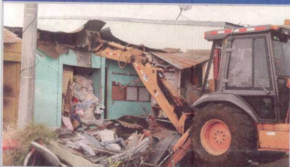
El Ministerio de Salud ordenó la demolición de la casa porque representaba un peligro para los vecinos. ROBERTO ACOSTA LT
