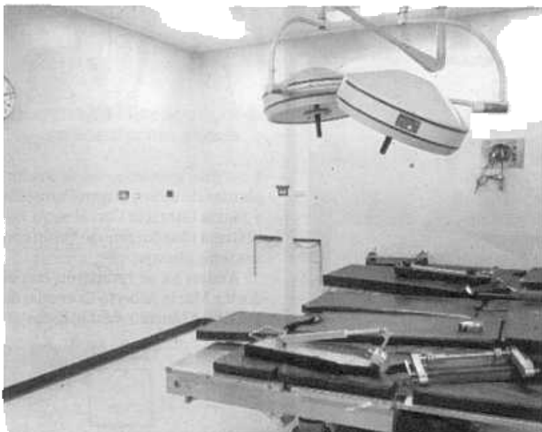
Los quirófanos están en muy malas condiciones. ARCHIVO
