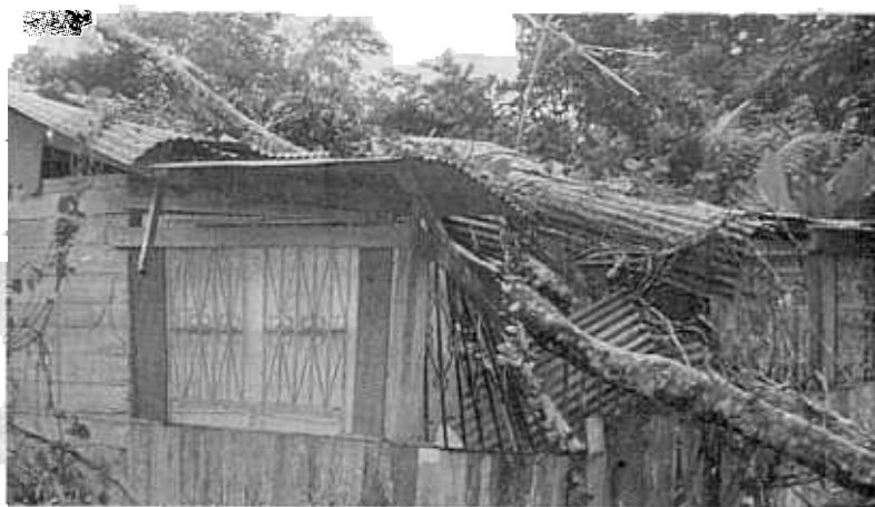
En Hone Creek, un árbol cayó sobre una casa por el tornado. R. AMORETTY GN
