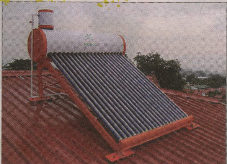
En casas o empresas, Greenrsys instala plantas solares como esta para la generación de energía limpia.
